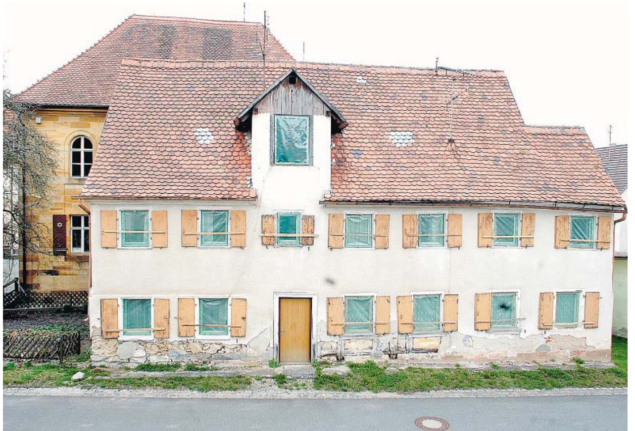
Seit Jahren wird über die Renovierung des Ermreuther Schwarzhaupthauses diskutiert. Jetzt will der Zweckverband das Projekt auch tatsächlich angehen. Foto: Harald Hofmann
